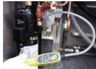
③ガス漏れ調査
