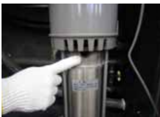
⑦水漏れ確認
