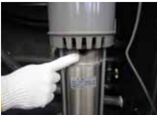
⑦水漏れ確認
